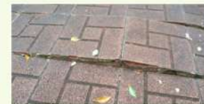
遊歩道の平板の浮き上がり
